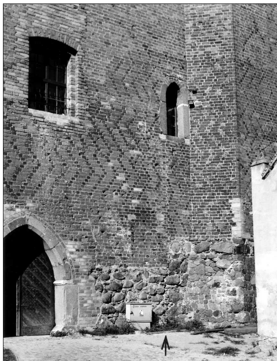
Abb. 11: Mewe/Gniew. Das Deutschordenshaus. Baunaht an der Ostfassade beim Bergfried (s. Pfeil), in der Nähe des sekundär eingepassten Einfahrtstores (1422). Foto Verfasser.
